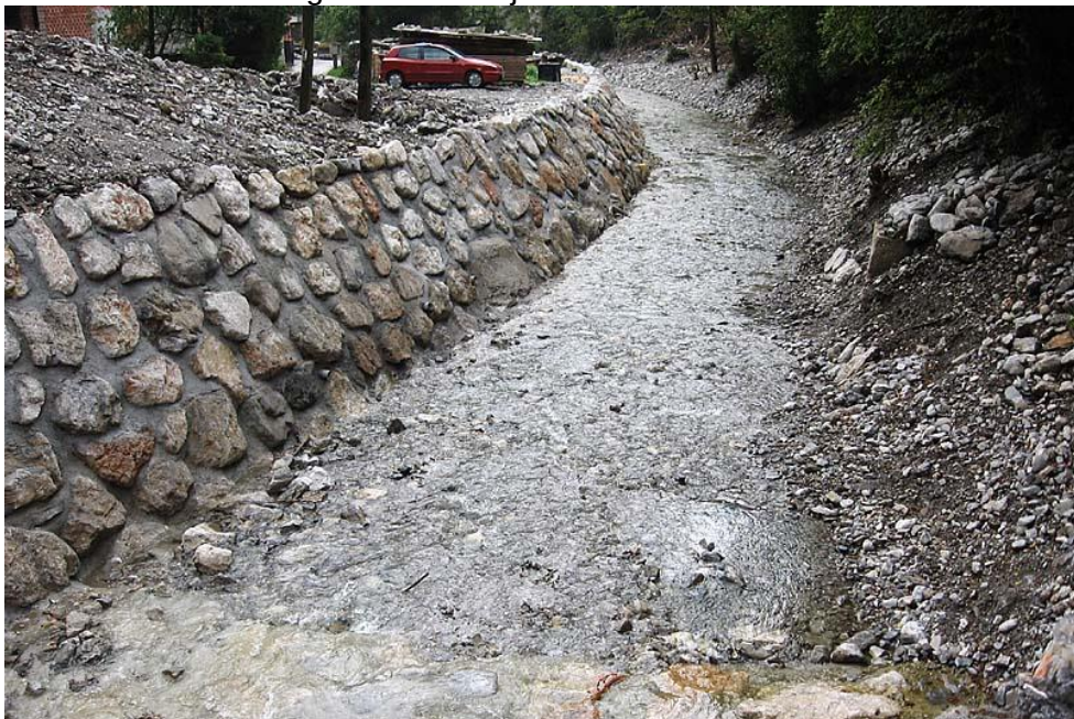
Slika 6: sanirana struga skozi naselje
