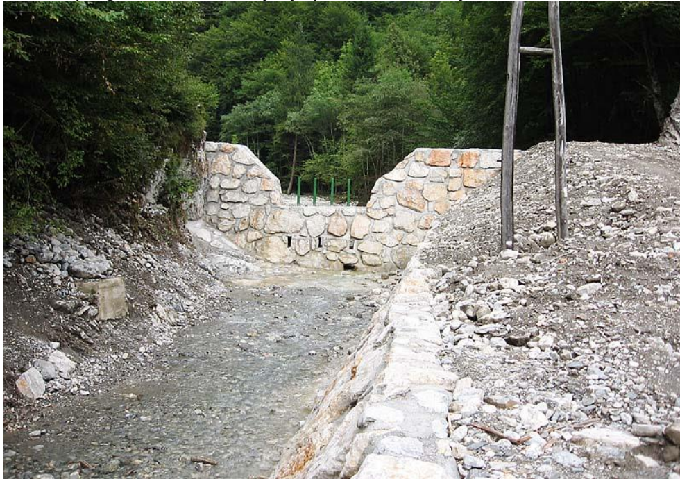
Slika 7: pregrada za zaustavljanje plavin nad naseljem
